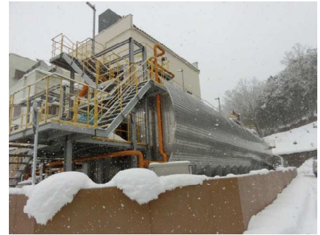
バイオガスを得るメタン発酵槽
